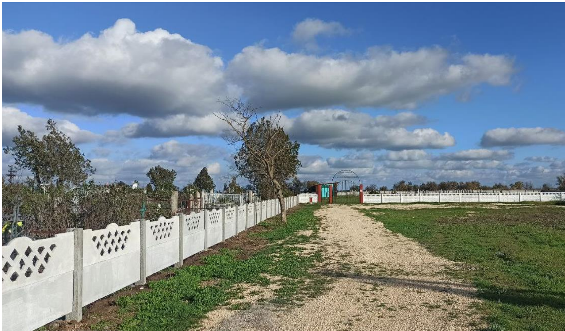
Работы по благоустройству территории кладбища, расположенного по адресу: Республика Крым, Нижнегорский район, с. Чкалово (в части установки ограждения, 90:08:190701:2697)
